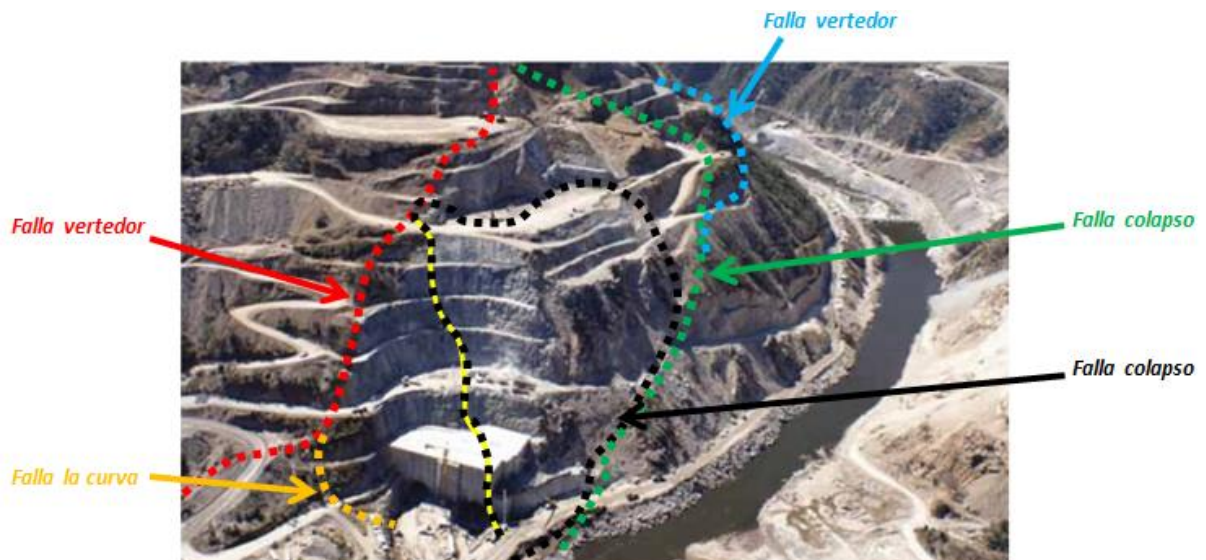
Imagen 8. 2 Vista de las fallas presentes en el proceso constructivo de los túneles de desvío en la presa La Yesca.
