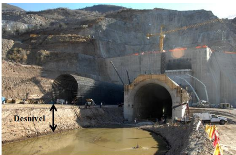
Imagen 4. 5 Desnivel en túneles de desvío en la presa La Yesca.
