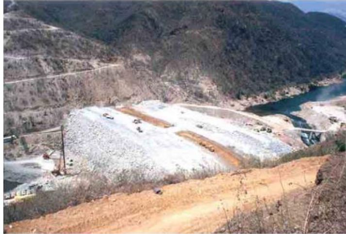
Imagen 3. 1 Construcción de ataguía tipo terraplén en la presa El Cajón, Nayarit, México.
