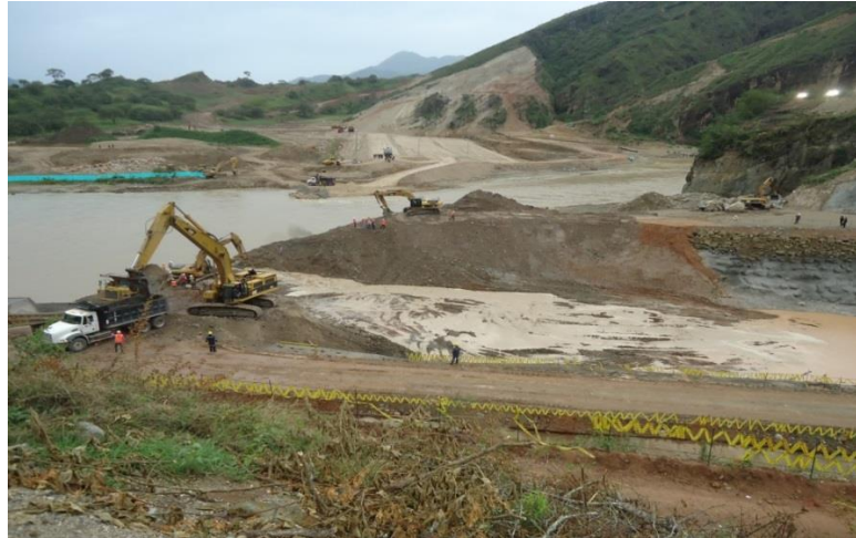
Figura 6. 8 Excavación del canal de llamada en el desvío del río Magdalena, Colombia.
