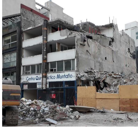
b) Después del sismo, modificada de (Sobse, 2018)
