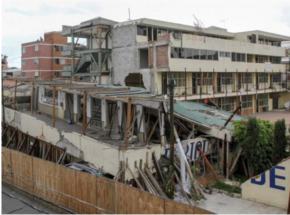
Fig. 1.14 Colapso parcial del colegio Rébsamen tras el sismo de septiembre del 2017
