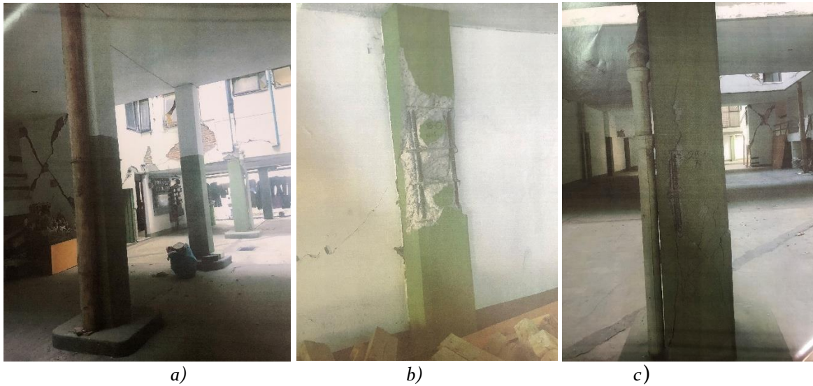
Figura 5. Daños de la estructura: a) planta baja, b) columna perimetral y c) columna central
