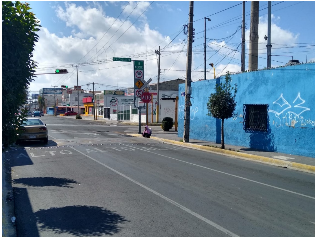
Fotografía 9. Ausencia de marcas en el arroyo vehicular.
