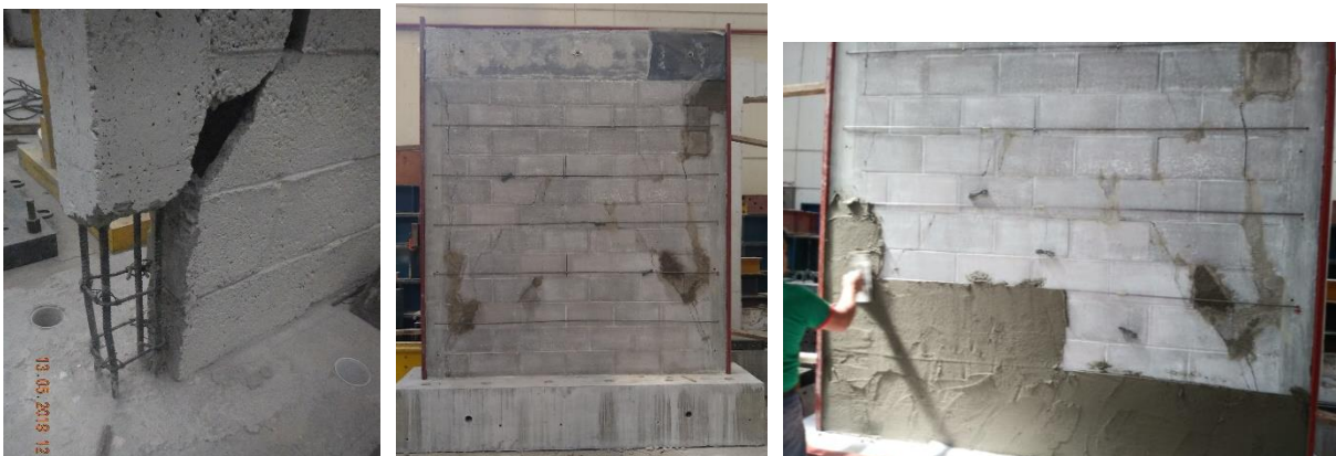
Figura 4.4 (Izq) Daño en el castillo MBC -1, (centro) reparación de MBC – 2 y alambre horizontales habilitados, (Der) Capa de mortero de 25 mm
