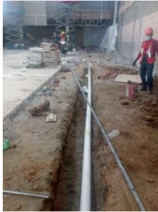
Fotografía 10.- Red Sanitaria de Locales Comerciales.
