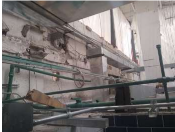
Fotografía 6.- Red de agua en Baños de Asociados.
