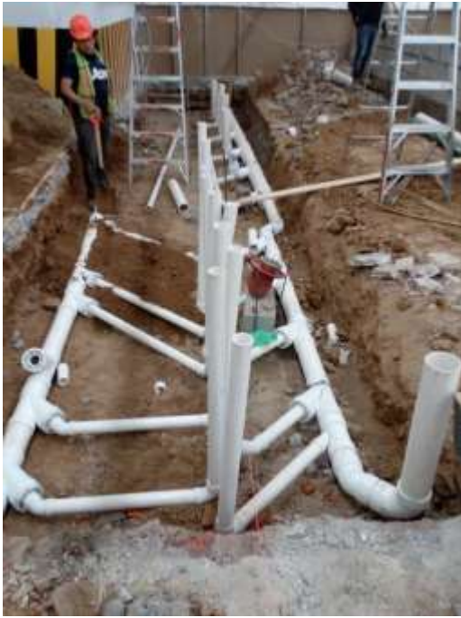
Fotografía 9.- Red Sanitaria de Baños de Clientes.
