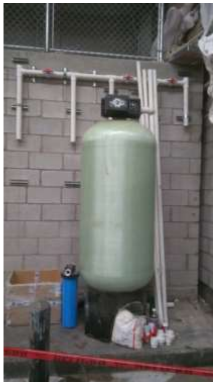
Fotografía 19.- Tanque de filtrado.
