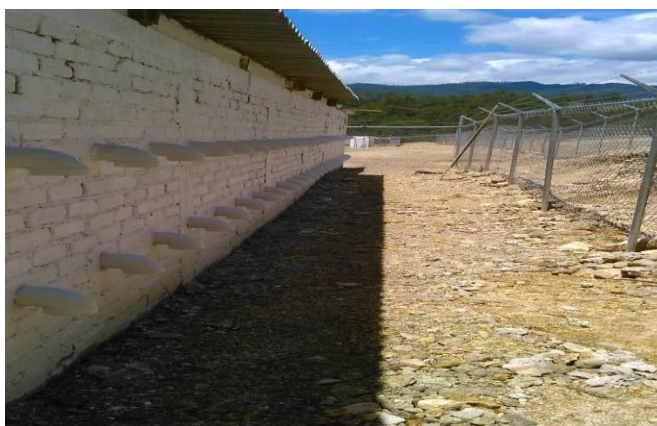
Fotografía 6. Claraboyas de ventilación.
