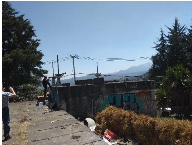
Figura II-8 Caja de válvulas a la entrada del tanque
