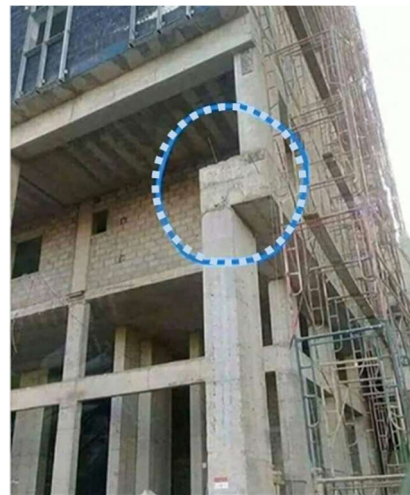
Figura 4.5 – Ejemplo de un error que afectará el desempeño de la estructura. [Civil Engineering Discoveries, 2020]
