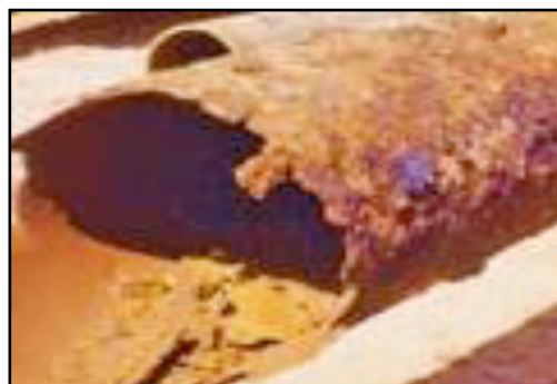
Figura 8.15. Corrosión de tubería de acero, ocasionada por el ambiente húmedo en el que fue instalada.
