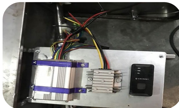
Ilustración 17 Cables desacomodados C
