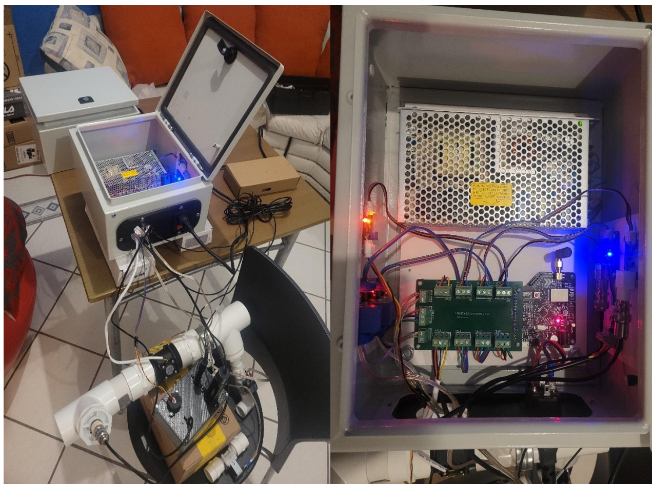
Ilustración 91 - Evidencia prueba de funcionamiento integral
