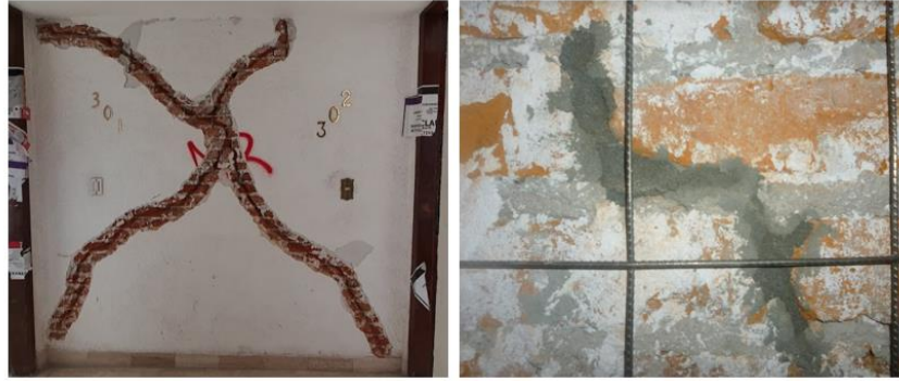
Figura 14. Preparación del muro para inyección de grietas (izq.) e inyección de grietas con mortero de cemento (der.) (Archivo fotográfico proyecto ConTex, 2018).
