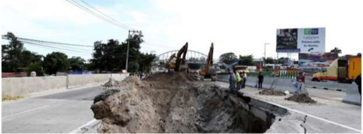
Figura 2.- Socavón de cuatro metros de diámetro y cinco de profundidad en el kilómetro 93+850 del Libramiento de Cuernavaca Morelos. (González, 2018)
