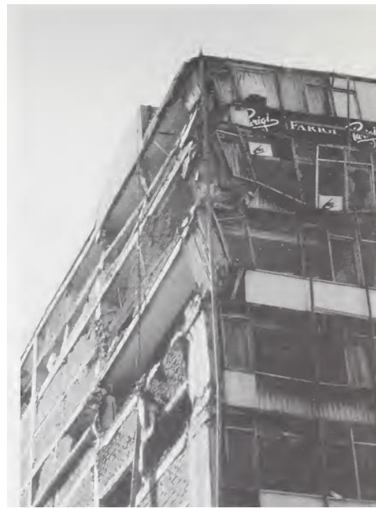
b) Impacto sobre las columnas en el edificio adyacente
