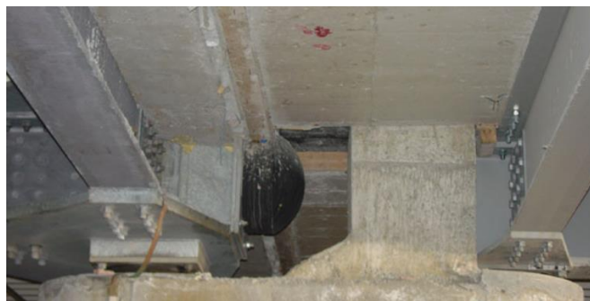
Figura 1.16 Banda de goma instalada en la junta constructiva de un edificio en Nicosia, Chipre (Polycarpou & Komodromos, 2014).
