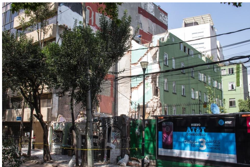
Figura 3.6 Fotografía del colapso del edificio en Amsterdam 25.
