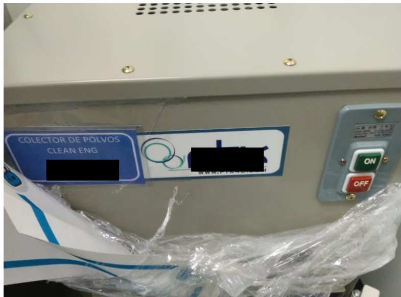
Imagen 30. Colector de polvos de Tableteadora Centro Técnico. Fuente: Elaboración propia
