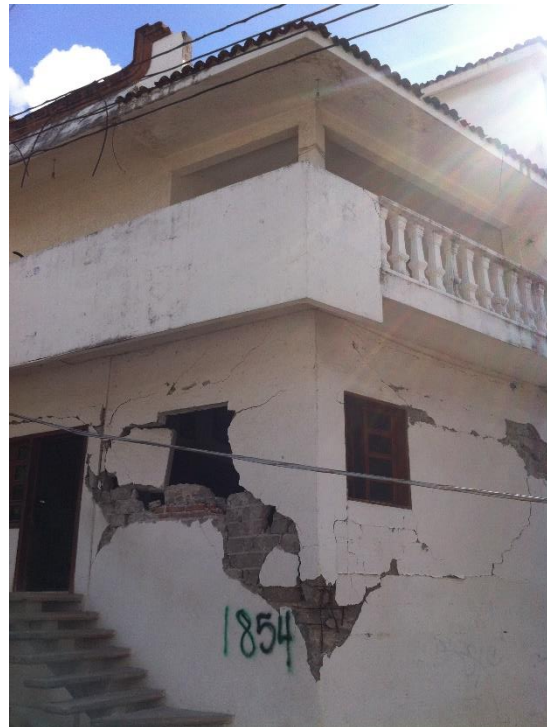
b. Agrietamiento por falla a cortante en muro de mampostería.
