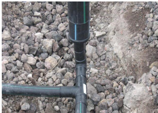
Instalación de red de reinfiltrado: Excavaciones, colocación de tubería, empackado de tubería con grava y colocación de piezas especiales.
