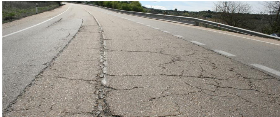
ILUSTRACIÓN 42 FATIGA DE UN PAVIMENTO; FUENTE: INTERNET
