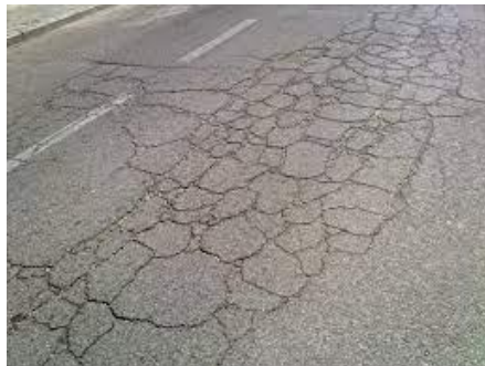
ILUSTRACIÓN 44 AGRIETAMIENTO EN FORMA DE “PANAL” O DE “PIEL DE COCODRILO”; FUENTE: INTERNET
