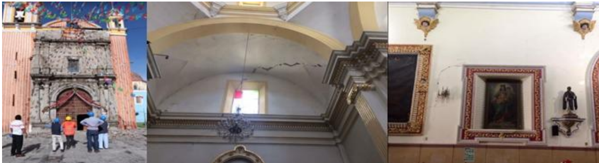
Figura 2.18. Desprendimiento de material en fachada principal y presencia de grietas al interior de la parroquia de nuestra señora de la Asunción, Amozoc, Puebla.
