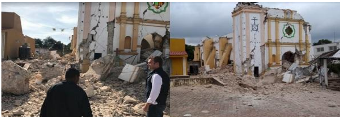
Figura 2.22. Desplome total de monumento histórico en Parroquia de Santiago Apóstol Atzitzihuacán, Pue.
