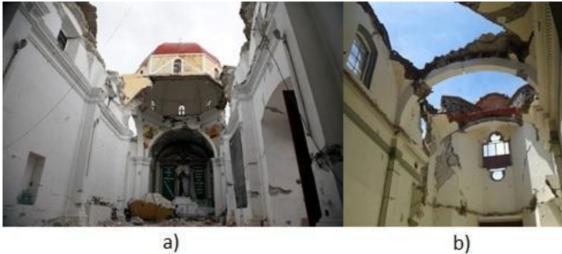
Figura 2.15. a) Caída de arcos y bóvedas en Parroquia de Santiago Apóstol, Atzala, b) Caída de bóveda en Exconvento del Carmen, Atlixco, Puebla.
