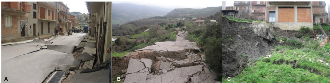
Fig. 12 Daño a la infraestructura resultado del deslizamiento en 2010.
