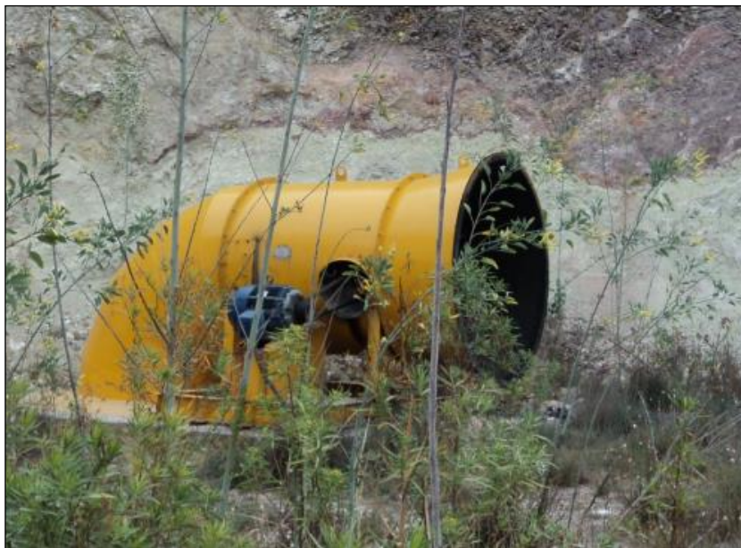
Ilustración 13. Ventilador después del mantenimiento general
