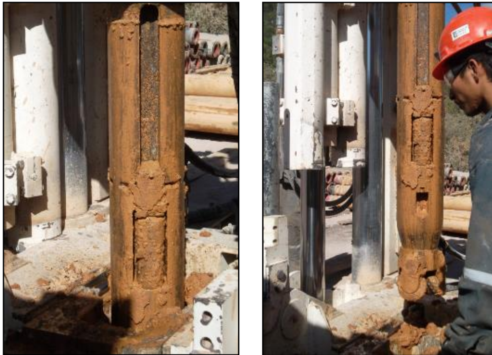
Ilustración 26. Barrena con problemas de lodo
