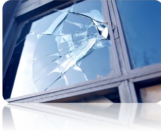
Figura 2.11. Falla de vidrio recocido
