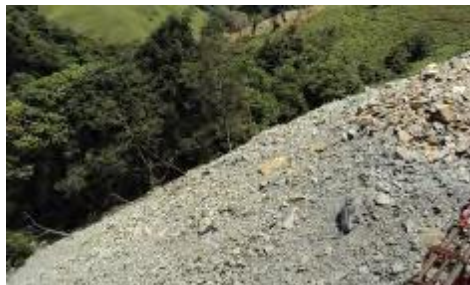
Figura 6.18 Material de corte en talud sin estabilizar Fuente (SCT, 2016)
