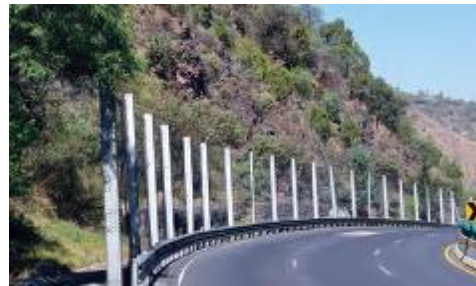
Protecciones metálicas con empleo de geomallas en pendiente rocosa complementado con Muro de Gavión para evitar Derrumbes sobre la Carretera
