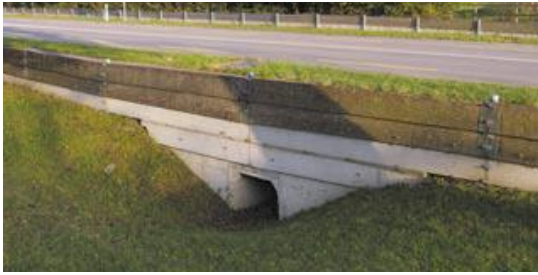
Paso específico para Anfibios y barrera permanente en la carretera Seestrasse, Cantón de Berna, Suiza.
