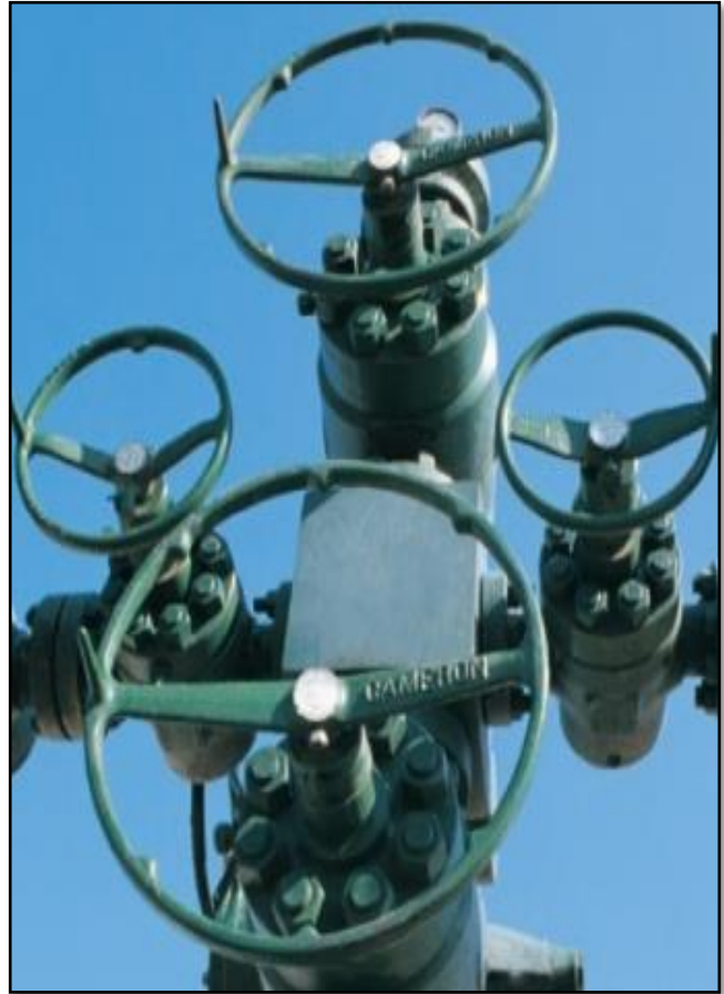
Imagen 39 Válvula de compuerta, TyM de pozos, FI. UNAM
