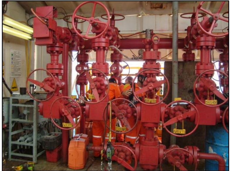
Imagen 40 Válvulas de estrangulación, PEMEX 2020.
