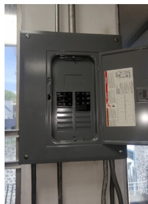
Figura 4-38: Imagen 6 Tablero B Laboratorio Microbiología de Cosmos
