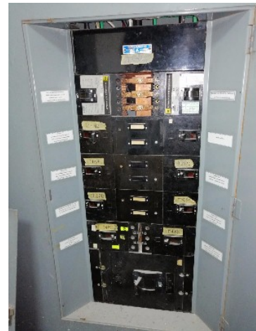
Figura 4-55: Imagen 18 Tablero de distribución derivado TD2
