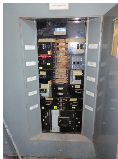
Figura 4-47: Imagen 12. Tablero de distribución derivado TD1
