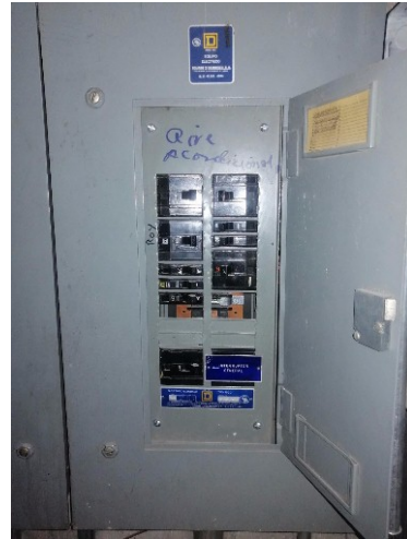
Figura 4-54: Imagen 17 Tablero de distribución T1N2
