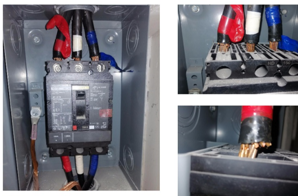
Figura 5-25: Imagen 21 Interruptor C
