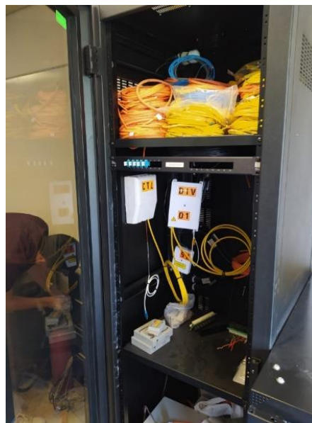
Figura 4.4 Rack del laboratorio de sistemas de comunicaciones ópticas.
