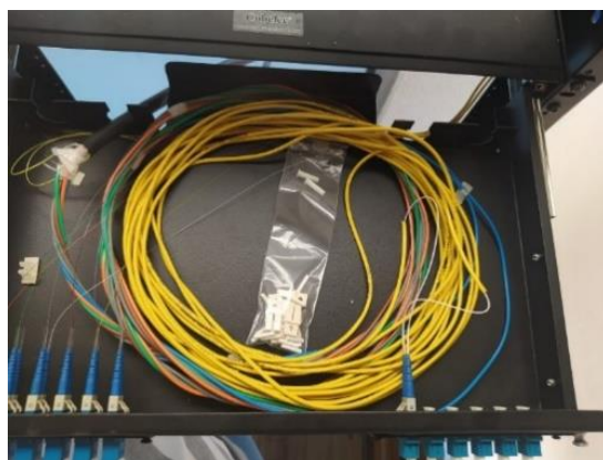
Figura 4.2 Distribuidor y panel de conectores del Aula de UNAM Mobile.
