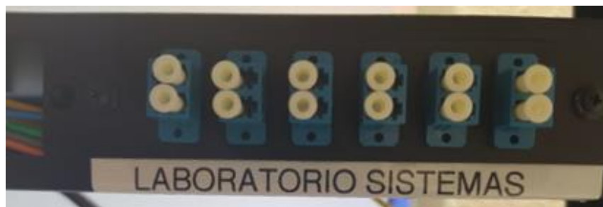
Figura 4.5 patch panel con conectores LC.
