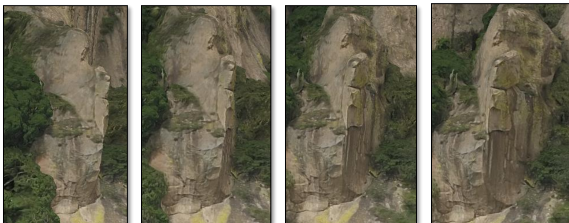
Figura 39. Modelo 3D que muestran un par de bloques localizado en la pared del Cerro Delgado. Se presentan las distintas perspectivas utilizadas para determinar si cumplen con las condiciones adecuadas para su desprendimiento.
