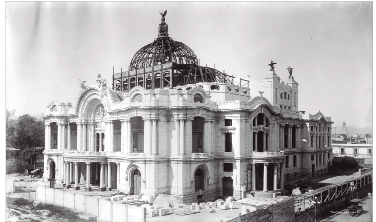
Construcción del Teatro Nacional (Palacio de Bellas Artes) © A2, TXIII, M-575 CONACULTA. INAH. FCR-V. Fondo Antigo. México
