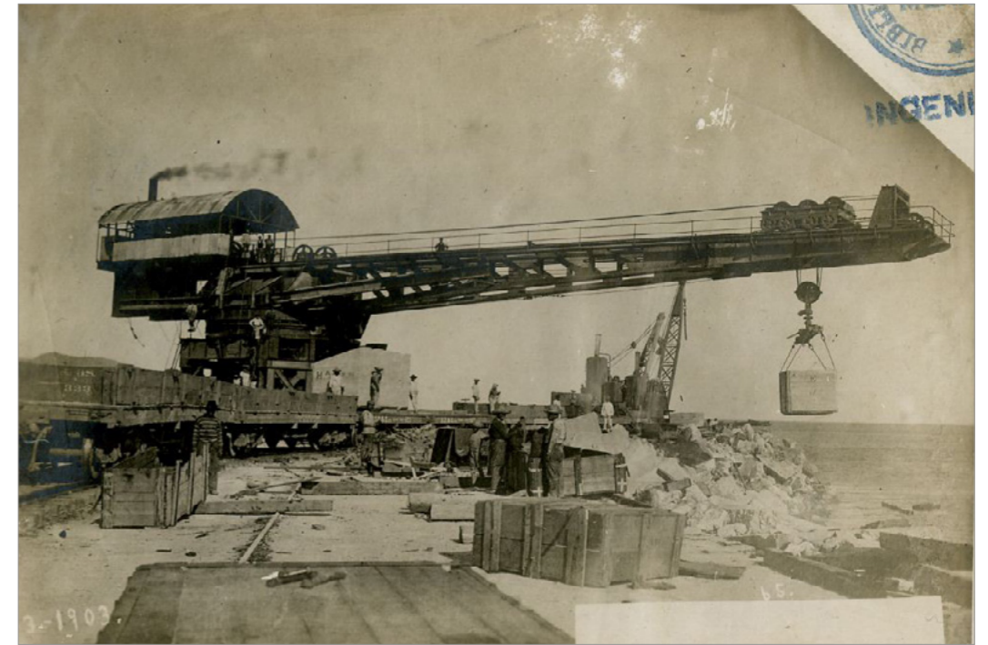
Grúa Titán con una capacidad de 50 toneladas utilizada en las obras de Salina Cruz
