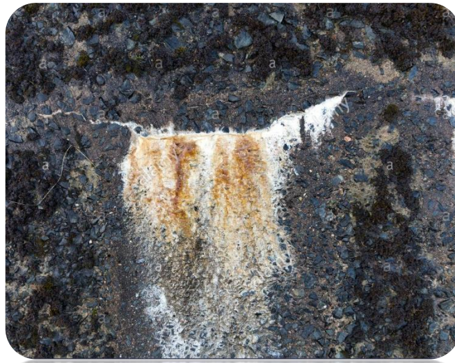
Ilustración 5 Eflorescencia emergiendo de una fractura en un pavimento.
