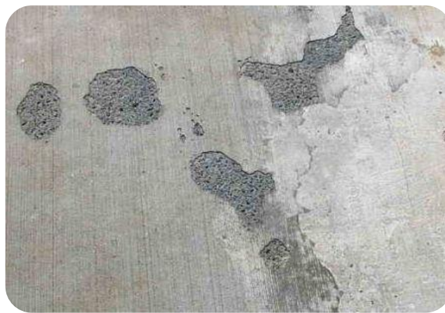
Ilustración 2 Suelo de concreto con Blistering
