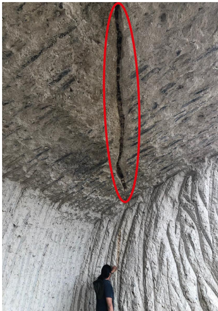
Figura 4.19 Pipa de desgasificación dentro de la ignimbrita de la Presa los Corrales
