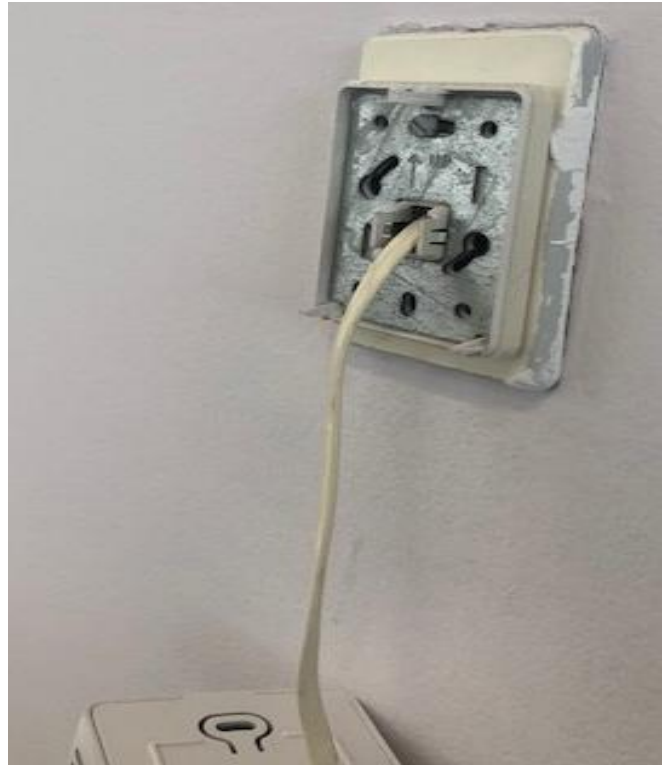
Figura 1.6. Termostato desconectado en un cubículo.
