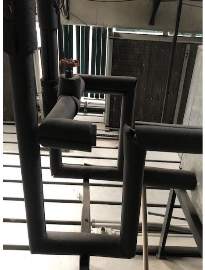
Figura 1.8. Control e instrumentación inexistentes.
