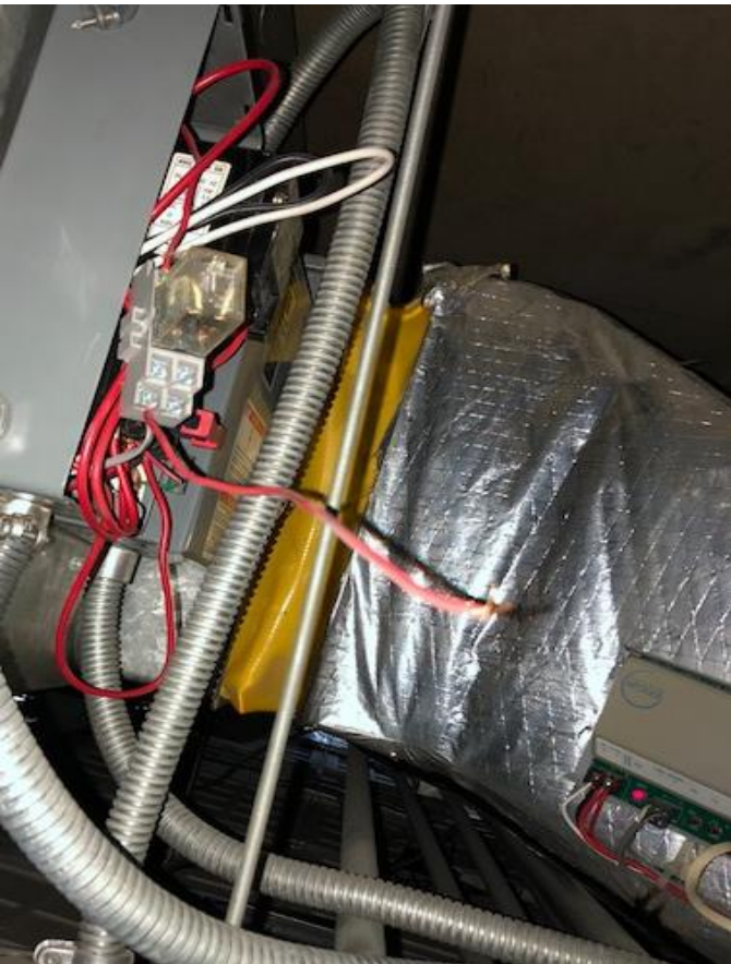
Figura 1.7. TEC en falla y relevador desconectado.
