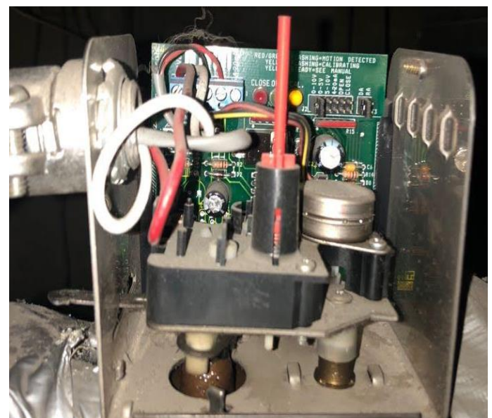
Figura 1.4. Actuador de válvula sin carcasa y descompuesto.
