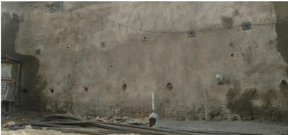
Fotografía 4. Aplicación de lechada de inyección a gravedad, contrario a lo que indica en el estudio.
