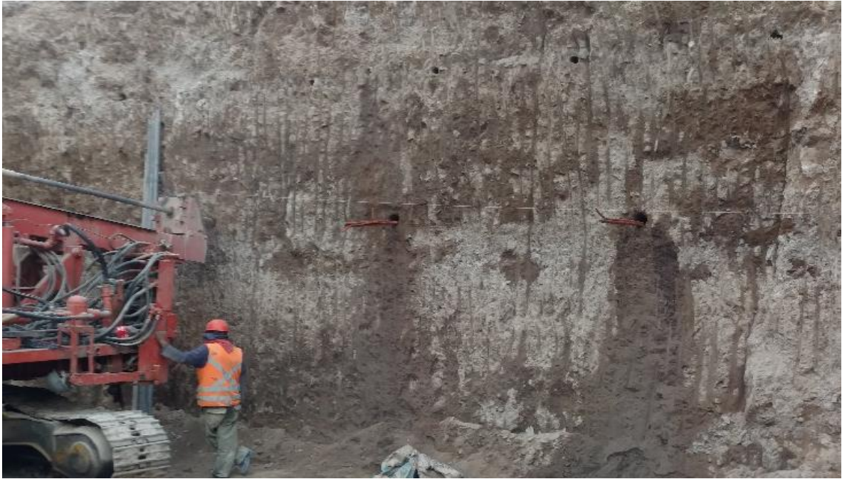
Fotografía 1. Colocación de un hilo para pasar el nivel de las perforaciones y proceder a barrenar.
