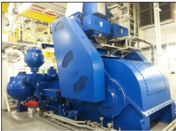
Imagen 9 Unidad de Bombas de una Plataforma Auto Elevable (Tomada de Petróleos Mexicanos, 2016)
