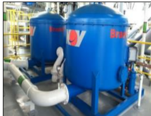
Imagen 14 Unidad de Líquidos de una Plataforma Auto Elevable (Tomada de NOV, 2019)
