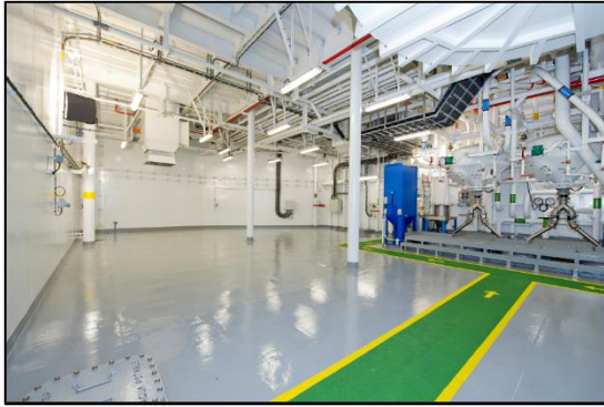
Imagen 8 Unidad de Almacenamiento de una Plataforma Auto Elevable (Tomada de Petróleos Mexicanos, 2015)
