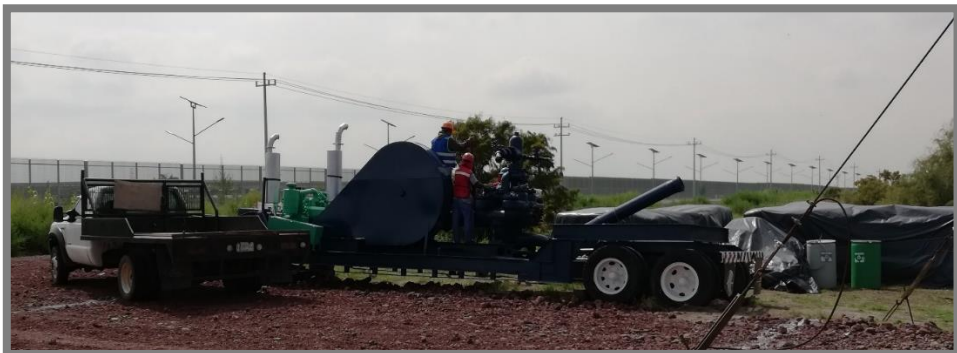
Ilustración 39 Bomba de inyección y retorno de lodos.
