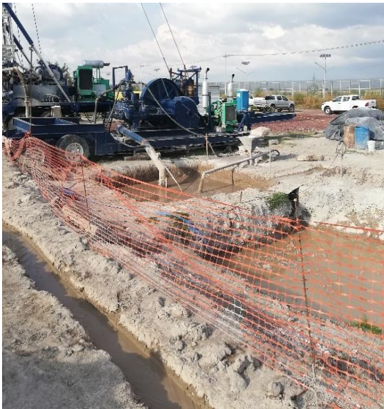
Ilustración 18 Fosa de fluido de perforación
