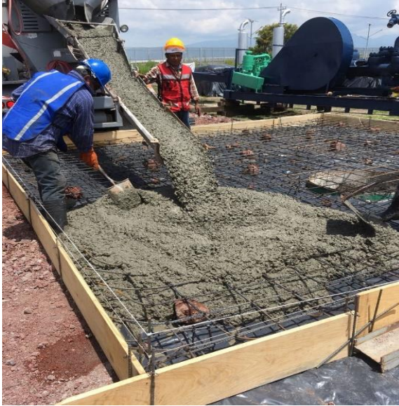
Ilustración 24 Vaciado de concreto para losa de cimentación instalada sobre el terreno nivelado.
