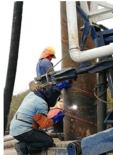
Ilustración 48 Unión de tubería lisa con soldadura de filete. Fuente: Elaboración propia.
