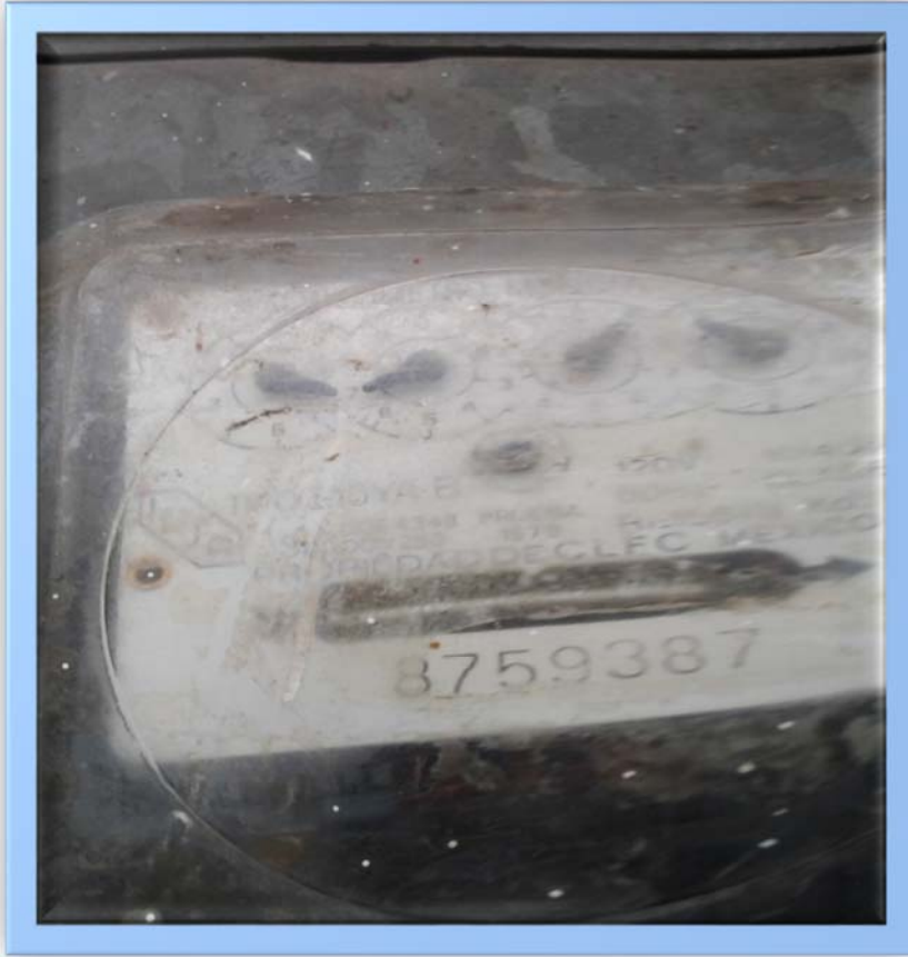
Ilustración 26 Observa medidor no se puede tomar lectura porque esta borroso y es ilegible, se tiene que realizar cambio de medidor
