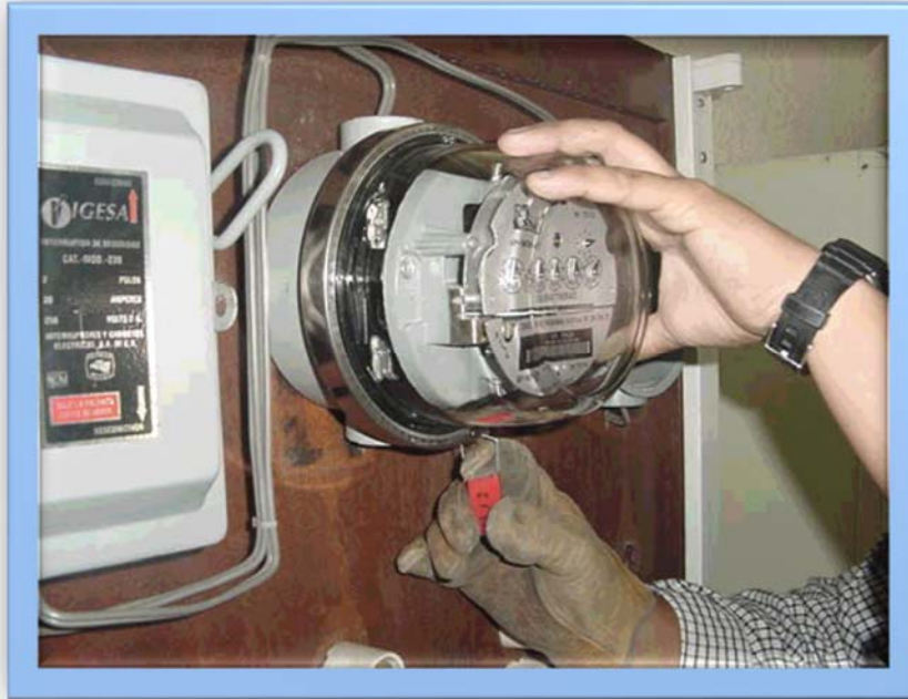
Ilustración 17. Verificación de sellos en medidor
