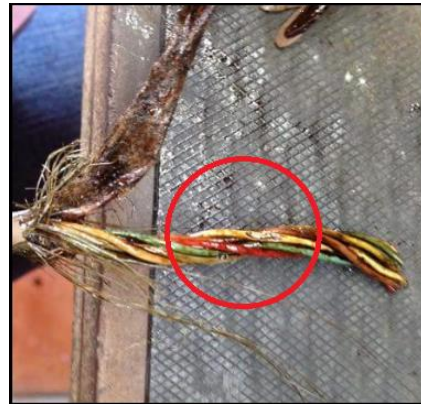
Figura 4.23 Daño en el material aislante de los cables del conector de control.
