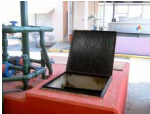
Fotografía III.1. Cárcamo de lixiviados de la planta de tratamiento de Bordo Poniente
