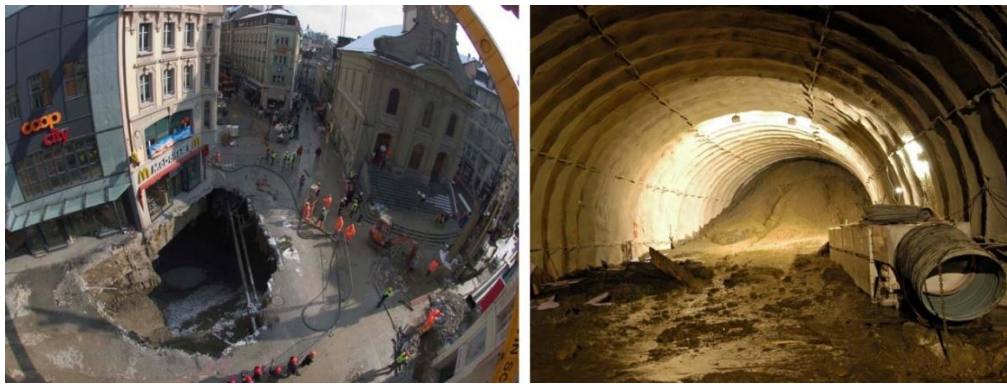
Figura 3.4. Colapso del metro de Lausanne, Suiza (2005).
