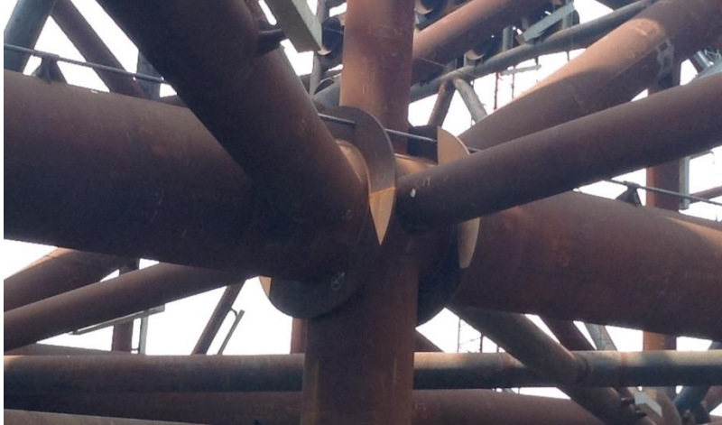
Figura 37. Anillos exteriores de refuerzo por colapso hidrostático. (Fotografía propia, 2013)
