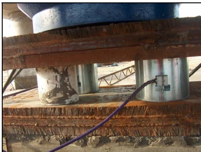
Figura 2.30. Imagen donde se muestran los gatos hidráulicos.
