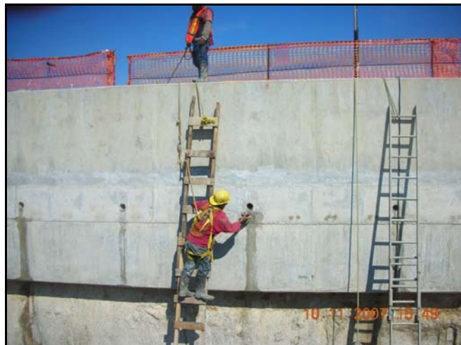
Figura 3.19. Fotografía donde se observan los tubos de PVC ahogados dentro del muro.
