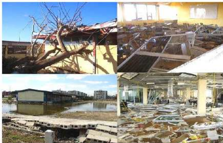
Figura II.7 Imágenes de daños en planteles en Quintana Roo por el Huracán “Wilma” en 2005. 159
