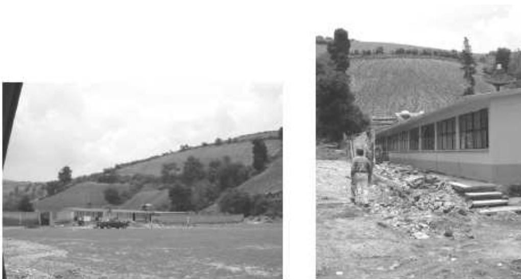
Figura II.2 Colapso de bardas en una tele-secundaria y un jardín de niños (nótese los canalillos generados en el terreno de cultivo y la deforestación que se observa arriba en la ladera). 107
