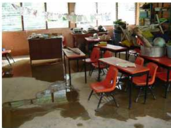
Figura II.6 Daños provocados a mobiliario y equipo. 151
