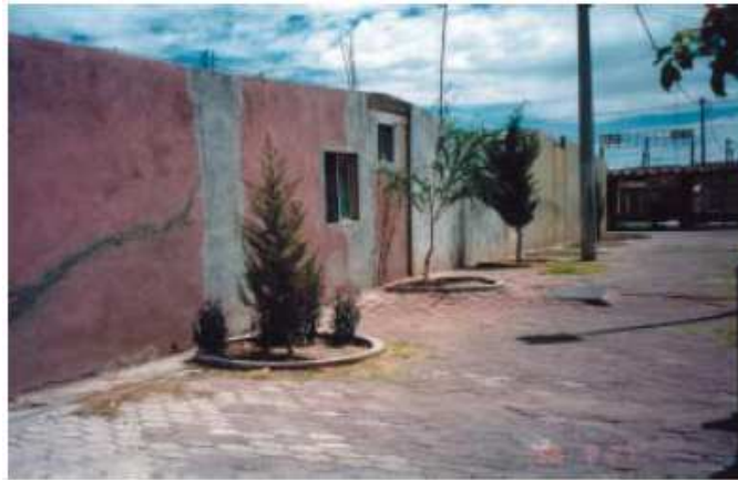
Figura I.24: Muestra de los daños estructurales irreversibles que se originan por los hundimientos diferenciales causados por la extracción de agua subterránea. 28
