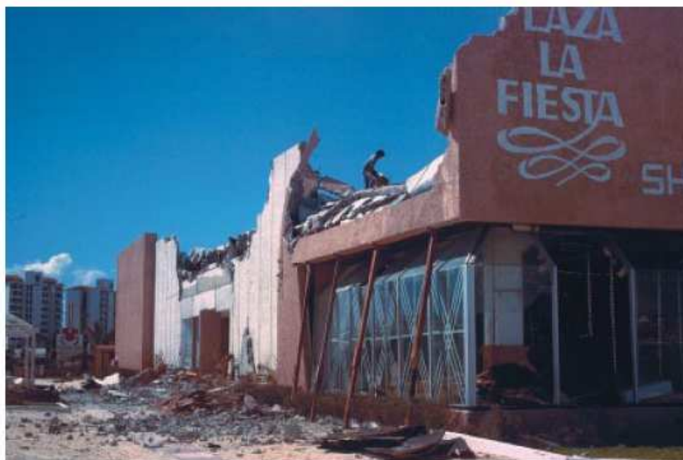
Figura I.38: Daños causados por el huracán Gilberto en Cancún. 42
