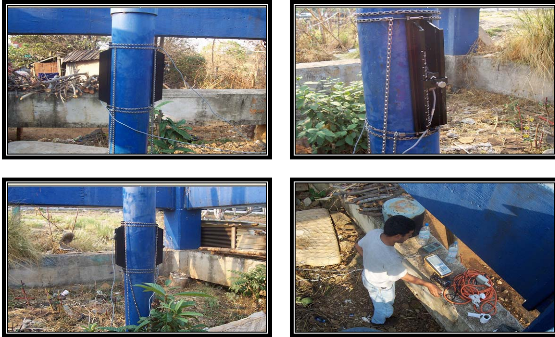
Foto 22, 23, 24, 25, 26,27, 28, 29, 30, 31, 32,33y 34 .- Mediciones en la tubería de 8” que baja del tanque elevado.
