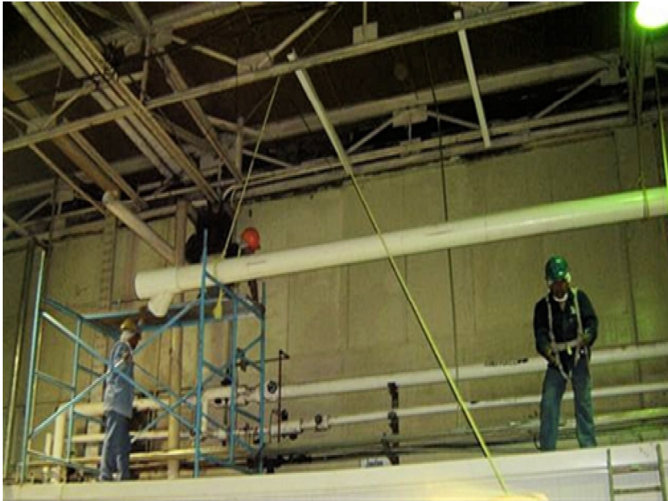
Foto19. Mantenimiento Modificado aplicado a una nueva instalación pluvial, para cumplir con la normatividad mexicana vigente
