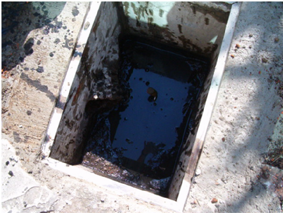
Foto 14. En este registro se observa que en el fondo se empieza acumular residuos sólidos
