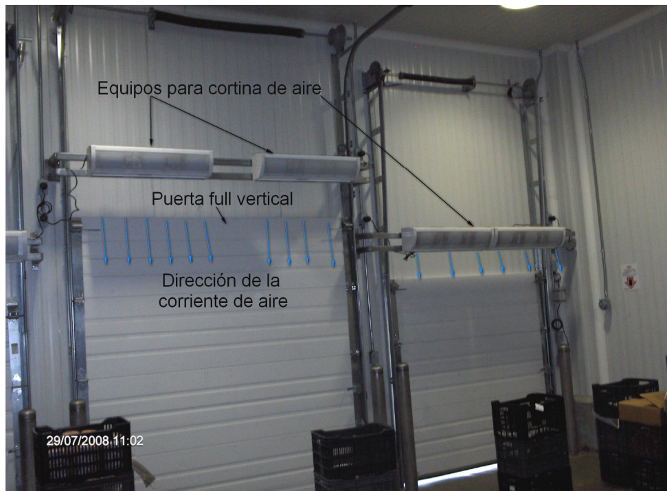
Foto 31 Puertas full vertical equipadas con cortinas de aire, para evitar la introducción de insectos
