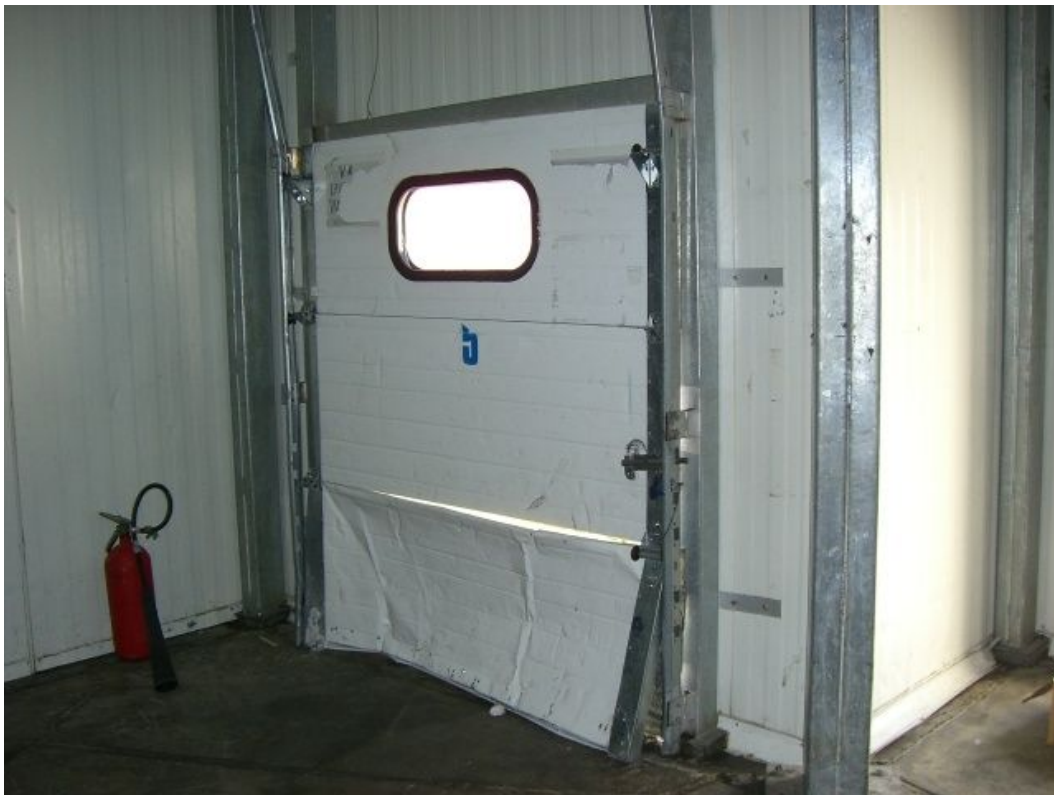
Foto 28. Observamos el daño solo en el tablero inferior, pero los mecanismos de la puerta están en buen estado
