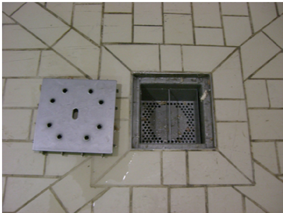
Foto 13. La instalación de sumideros sifónicos de acero inoxidable, tuvo un impacto positivo pues se evita el Mantenimiento Correctivo del correspondiente desazolve de los registros y cañerías internas
