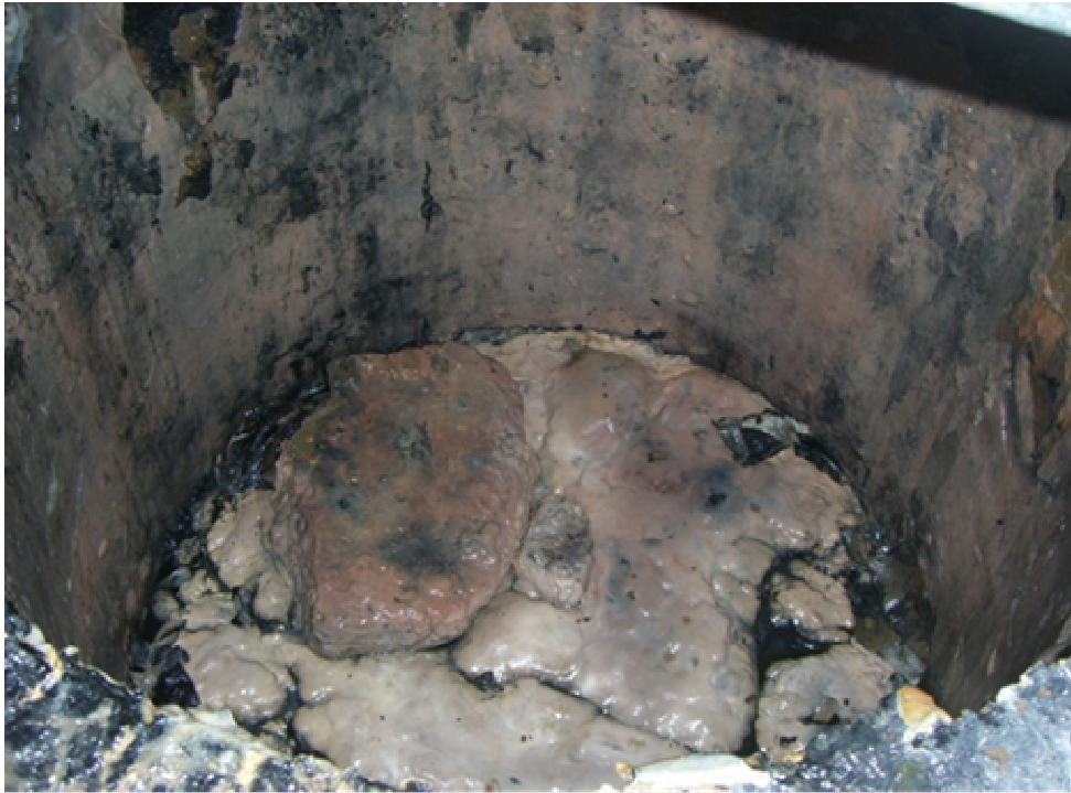
Foto15. En este pozo de visita se observa en el fondo una cantidad considerable de sólidos
