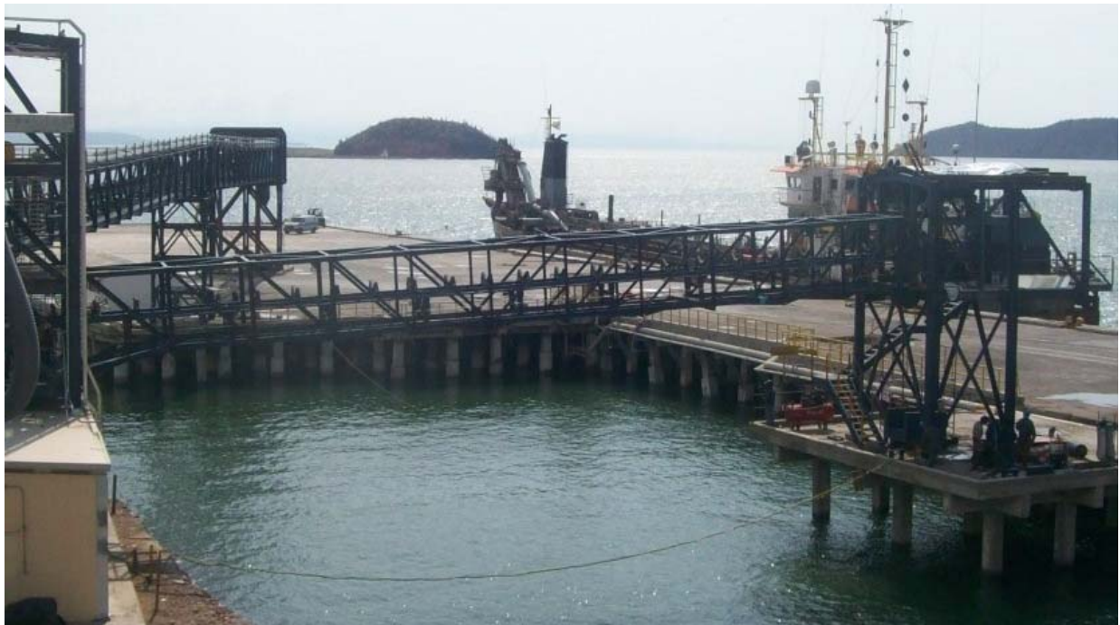
Vista general de transportadores TBS-04 y TBS-05 y torres TT-5 y TT-6.
