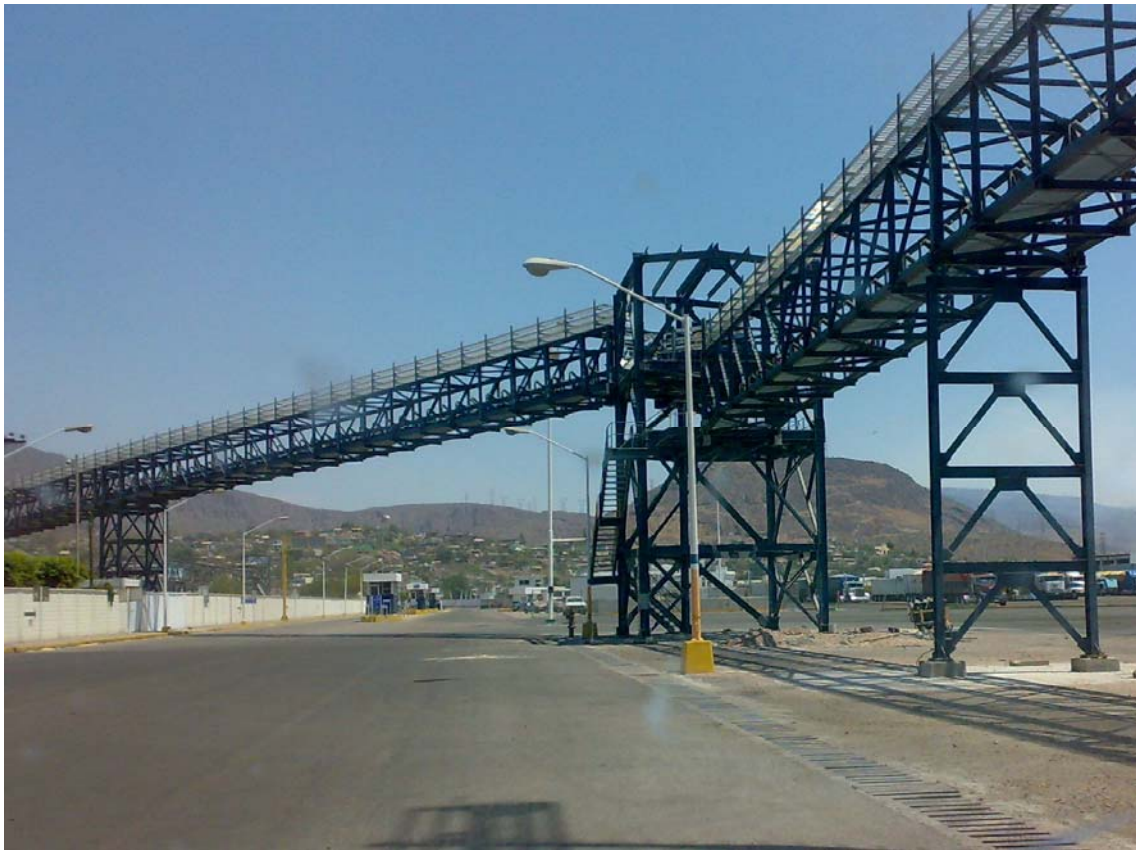
Vista general de transportador TBS-01 llegando a TT-1 y salida de TBS-02.
