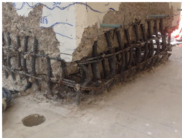
Figura 1. 12 Falla de las varillas longitudinales por pandeo
