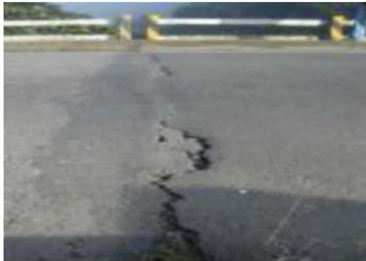
Figura 2.5.1.18 Grietas de reflexión.
