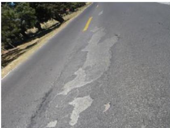
Figura 2.5.1.3 Pérdida de rodadura.
