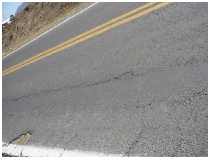
Figura 2.5.1.12 Asentamientos transversales y longitudinales.
