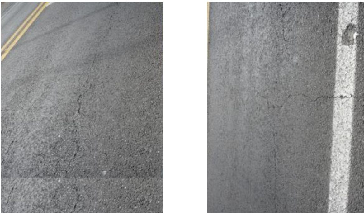
Figura 2.5.1.14 Grietas longitudinales y transversales.
