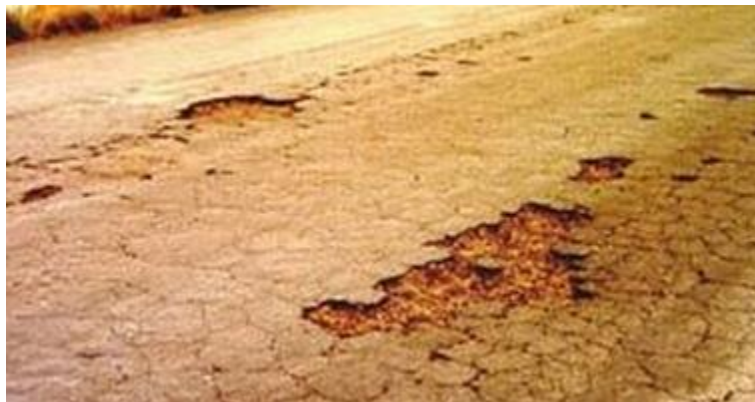
Figura 1.5.2.1 Fisuras y grietas por fatigamiento.
