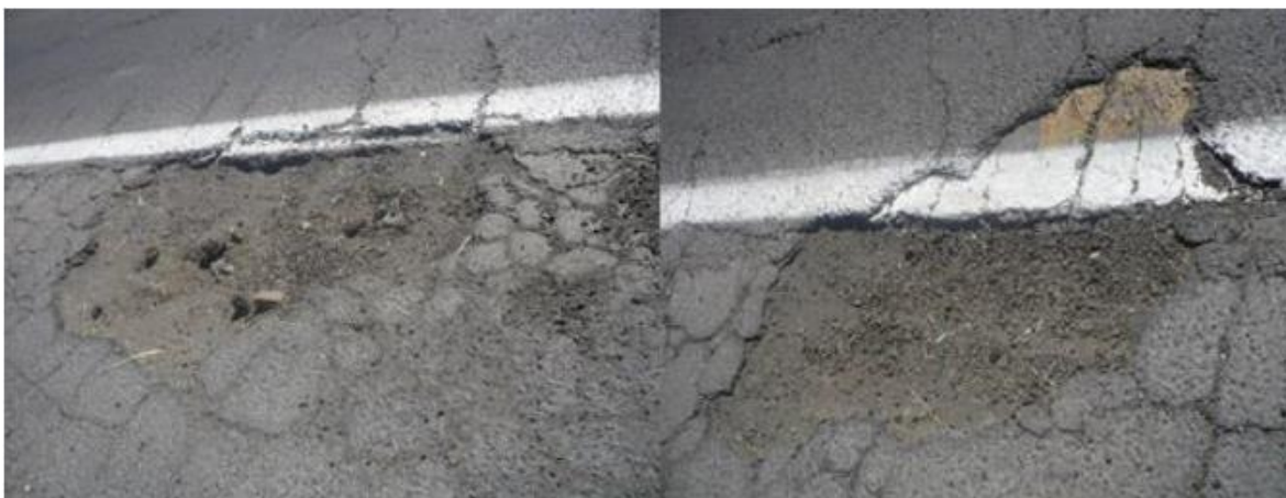
Figura 2.5.1 Pérdida de agregados/Pérdida de la base/Bache superficial.
