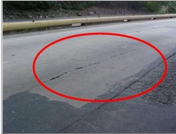
Figura 1.5.2.9 Fisuras y grietas transversales.
