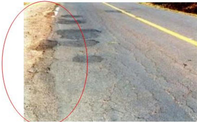
Figura 1.5.2.7 Grietas de borde.
