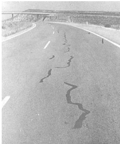
Figura 2.5.1.19 Grietas en zig-zag.
