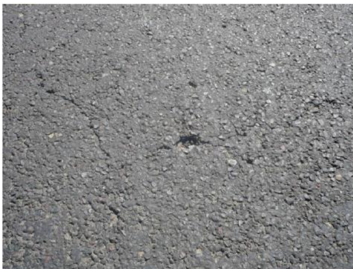
Figura 2.5.1.1 Desprendimiento de agregados.
