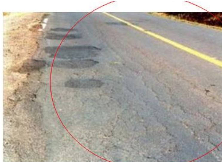
Figura 1.5.2.8 Fisuras y grietas longitudinales.
