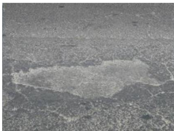
Figura 2.5.1.4 Desprendimiento de sello.
