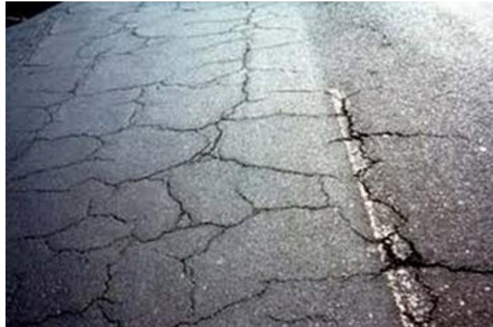
Figura 1.5.2.6 Fisuras y grietas en bloque.
