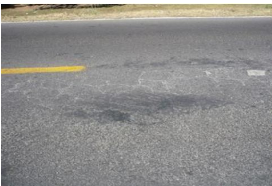
Figura 2.5.1.5 Llorado de asfalto.
