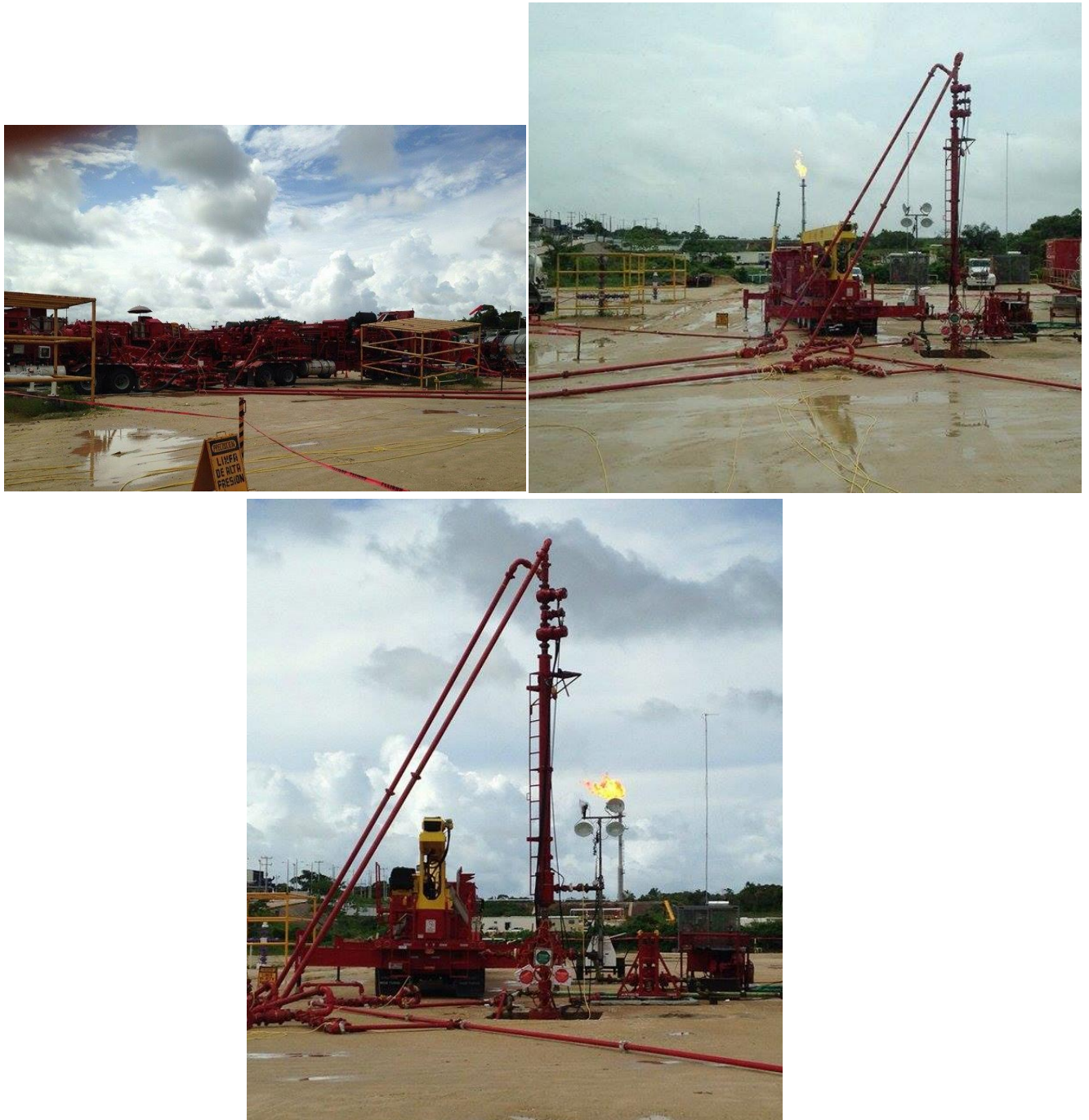
Fig. 5.19. Unidades de bombeo, pozos vecinos y pozo Jun 1 con equipo para prueba de minfrac.
