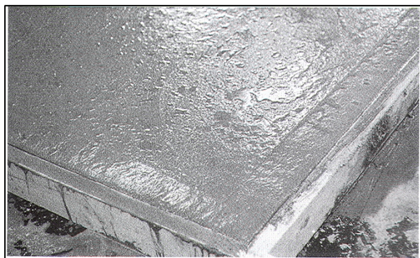
Fig. 1.15 Agua de sangrado en la superficie de concreto recién colado en la losa
