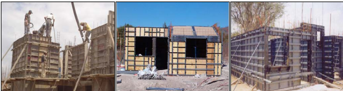
Fig. 5.13 Moldes metálicos para concreto monolítico en muros y losas en Viviendas de interés social.
